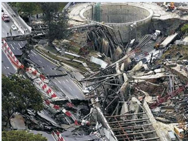
Разрушения на строящейся линии метрополитена в Сингапуре в апреле 2004 г.
